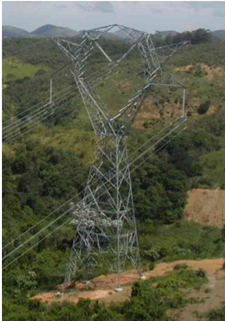
Figura 6 - Torre típica da LT 500 kV Cachoeira Paulista - Adrianópolis III de FURNAS
