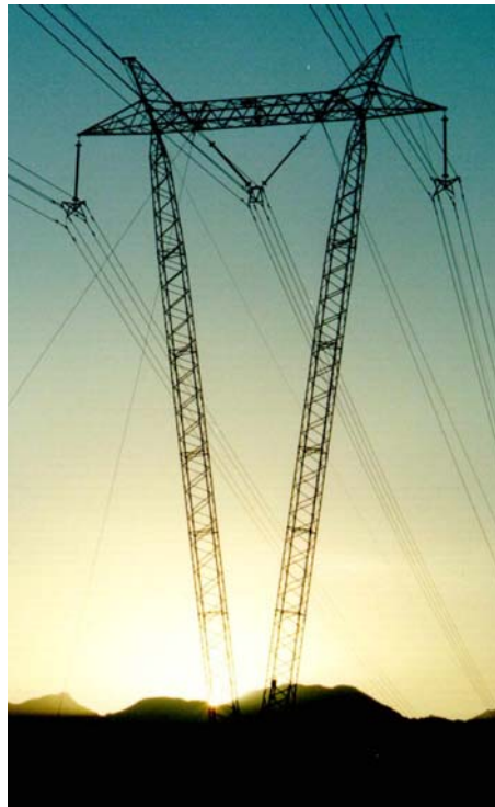
Figura 3 - Torre típica da LT500 kV Presidente Dutra – Teresina – Sobral – Fortaleza da CHESF
