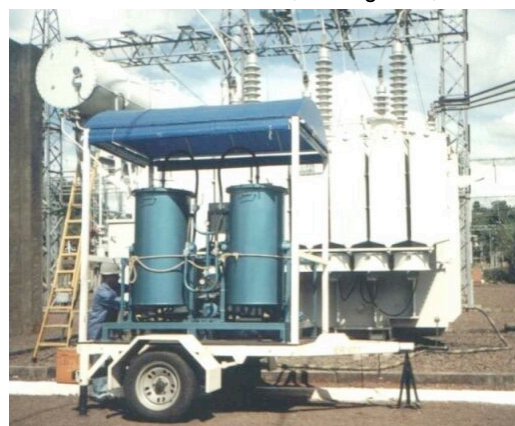
FIGURA 3 - Transformador 138 KV Energizado
