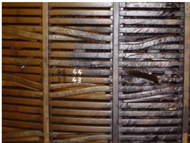
Figura 6. Ponto de falha lado externo da bobina de alta de 230 kV
