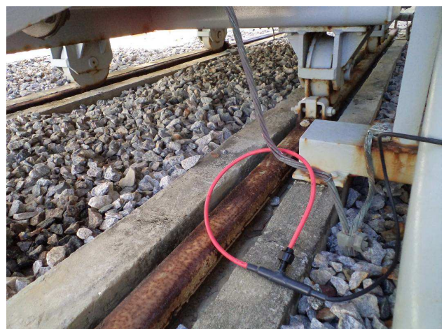
Figura 9. Medição da corrente no aterramento.
