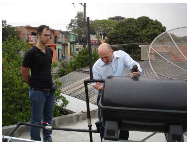
Figura 8. Verificações procedidas em 05/10/10. Em primeiro plano o reservatório de água quente instalado, na cor original de fabricação sem pintura.
