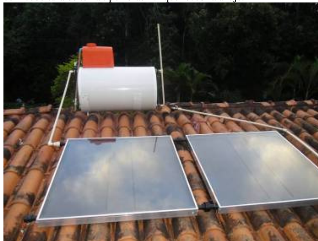
Figura 14. Instalação de sistema com reservatório do tipo 3. A peça de cor laranja apenas cobre uma bóia que tem a finalidade de quebrar a pressão da água que aporta ao sistema.
