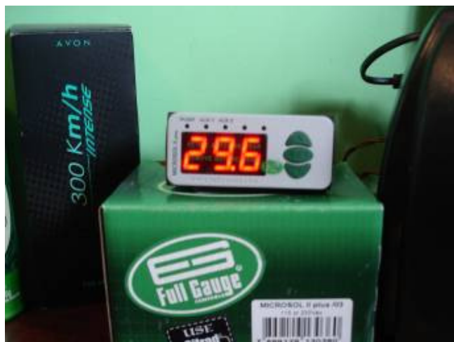
Figura 6. Leitura do sensor da temperatura da água na saída do reservatório para o chuveiro, em verificação logo após a instalação.
