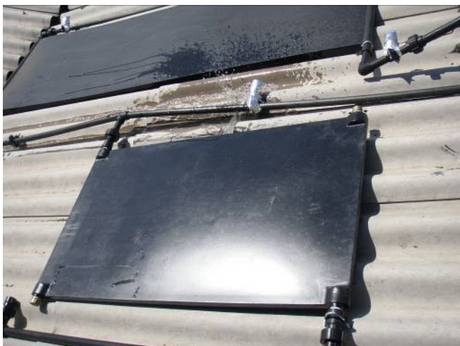
Figura 1. Placa de Fibra de Vidro durante os testes de desempenho simul-tâneos nas 3 alternativas de coletores. Ocorreu rachadura e vazamento.
